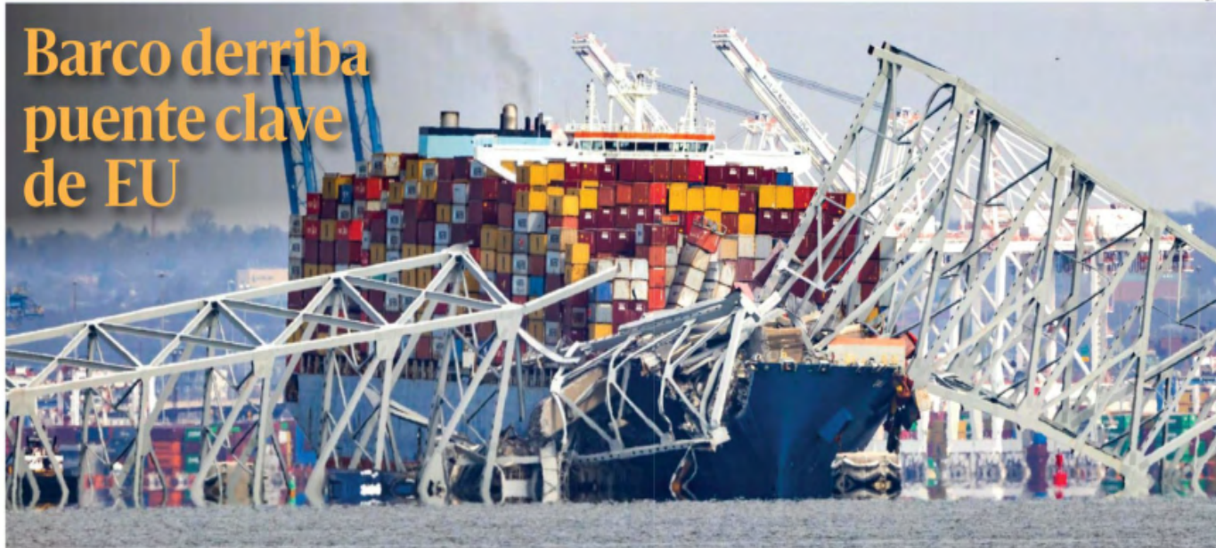
El buque de carga con 10 mil contenedores quedó incrustado entre el hierro del puente colapsado debido a la colisión. La nave había salido del puerto de Baltimore.
