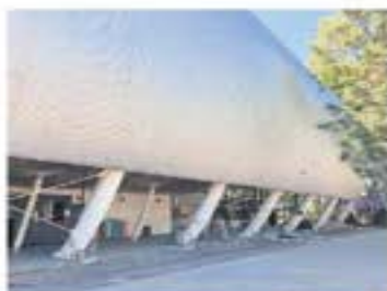
Las fachadas de las escuelas se encuentran en su estado, debido a la falta de mantenimiento.
