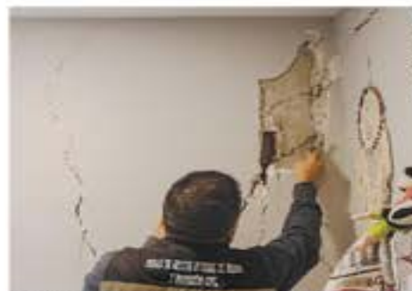
Personal de Protección Civil revisa los muros por los señalamientos en el conjunto habitacional Los Patios, en México.
