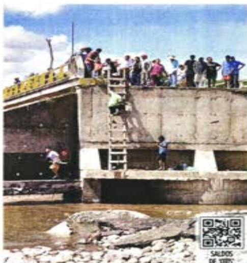
ASLADOS. El puente que conecta a Ajuchitlán con San Miguel Totolapán, en Guerrero, se derrumbó y dejó aisladas a varias comunidades.
