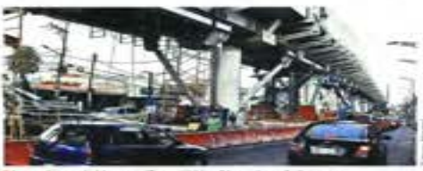
Las obras del tramo Zapotitlán-Nopalera fallaron.
