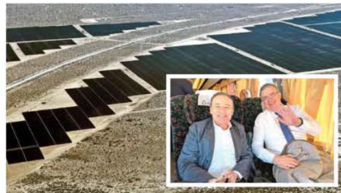
Encabezados por el canciller Marcelo Ebrard y el gobernador Alfonso Durazo, representantes de más de 65 países conocieron las obras de la Central Fotovoltaica de Puerto Peñasco, en Sonora.
